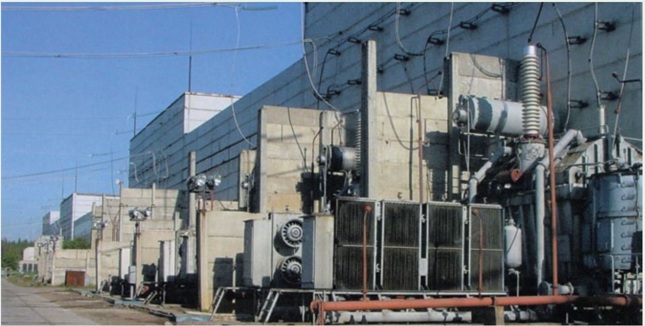
Здания комплекса преобразовательных устройств Выборгской выпрямительно-инверторной подстанции
